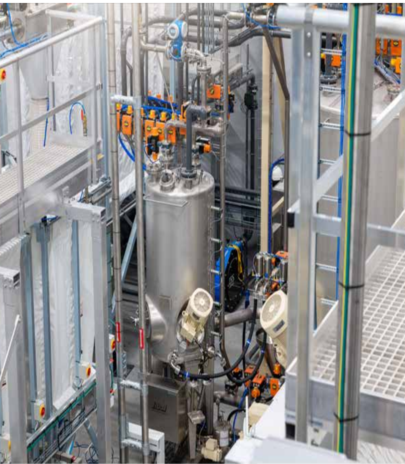
Fig. 4 Sistema de doble tanque ystral en Steen-Hansen que consta de dos recipientes de proceso que incorporan mezcladores YSTRAL Jetstream, un recipiente para polvo y el dispersor en línea YSTRAL Conti-TDS (créditos de las imágenes: Steen-Hansen).
