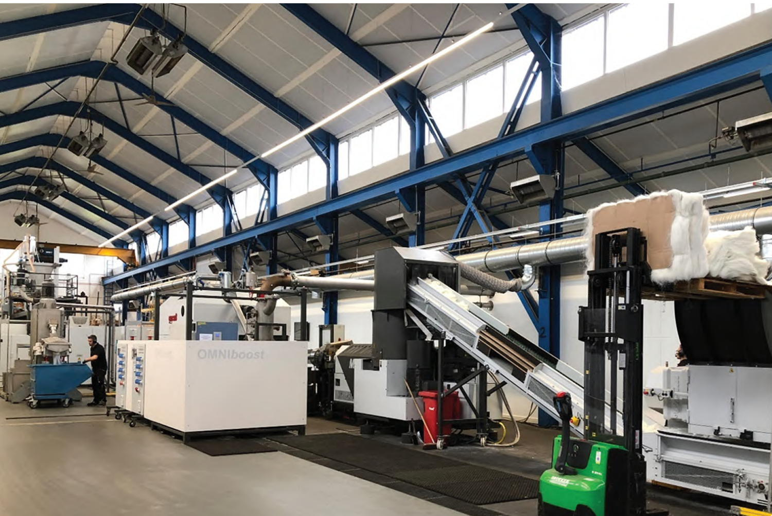
Sistema de reciclaje OMNIboost en funcionamiento en el centro técnico de Gneuss en Bad Oeynhau- sen
